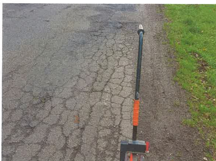
Fot. 2 Liczne uszkodzenia krawędzi jezdni
