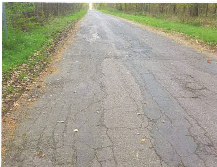
Fot. 1 Ogólny stan nawierzchni drogi powiatowej
