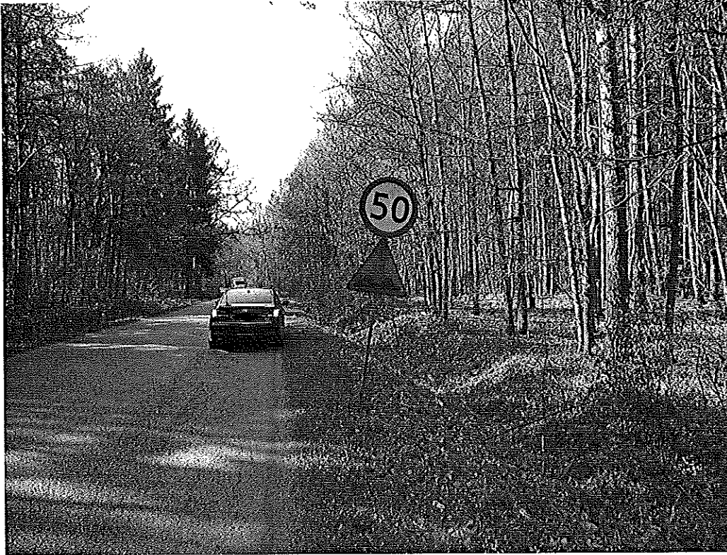
Droga powiatowa nr 4161Z Niewłaściwa kolejność umieszczenia tarcz znaków B-33 i A-11 na wspólnej konstrukcji wsporczej (na odwrót). Konstrukcja wsporcza znaków przekrzywiona. Znak A-11 zabrudzony.
