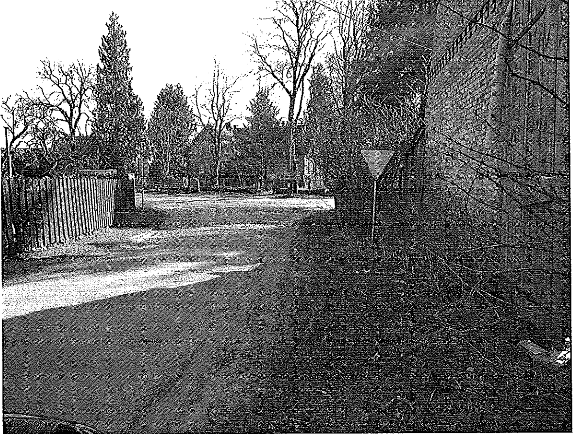
Droga powiatowa nr 4137Z m. Czermnica – skrzyżowanie z drogą powiatową nr 4160Z. Znak A-7 zniszczony. Brak oznakowania poziomego skrzyżowania, jako miejsca szczególnie niebezpiecznego. Zapiaszczone pobocze.
