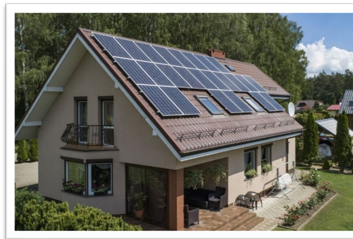
Instalacja fotowoltaiczna zlokalizowana na dachu
