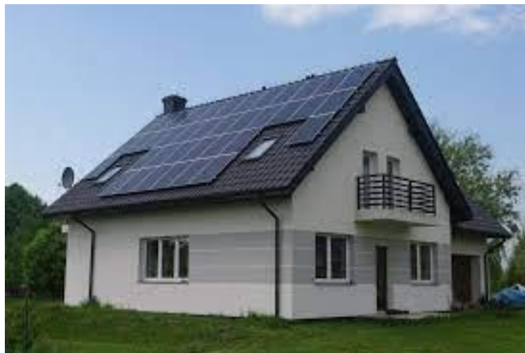
Instalacja fotowoltaiczna zlokalizowana na dachu
